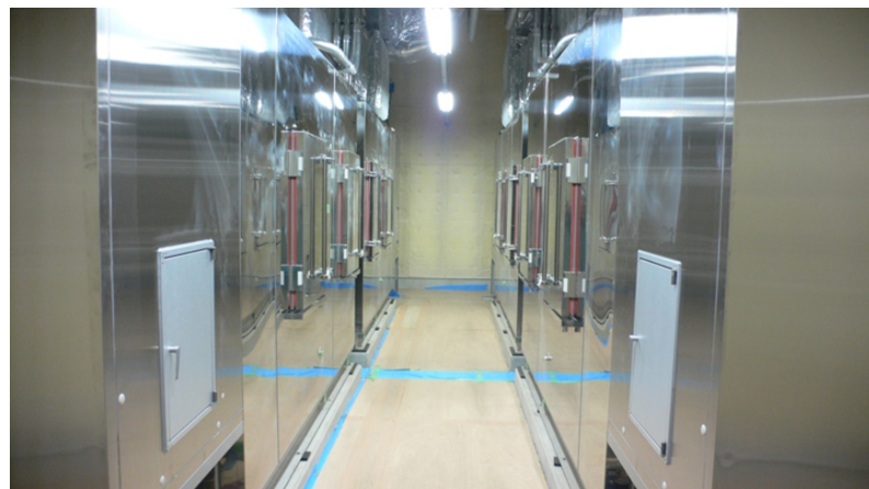
写真一2 空調機本体
