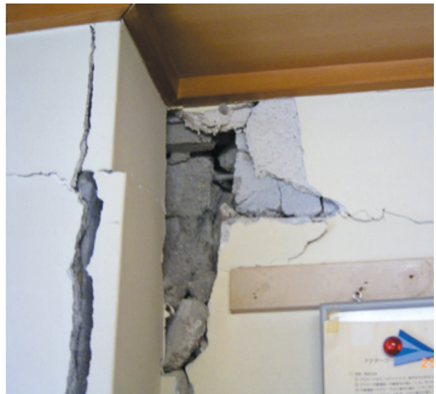
（臨床分室）壁が激しく破損。柱は問題ないので安全との事
