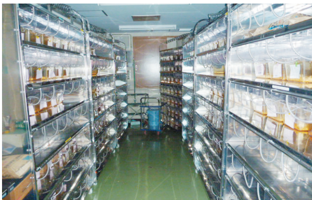
（中央棟）飼育棚は固定されていたが、地震により移動した。しかし、棚の転倒やケージの落下はなし
