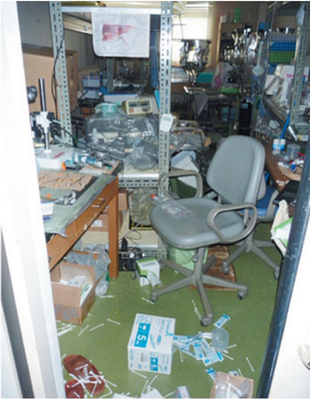
(中央棟) 殆どの実験室は、器具が散乱して器材が破損した
