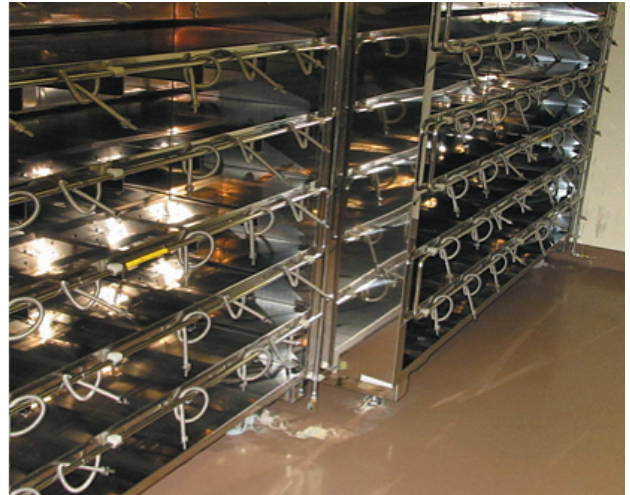
(中央棟) 重い飼育棚の移動で、床面が固定金具でえぐられていた
