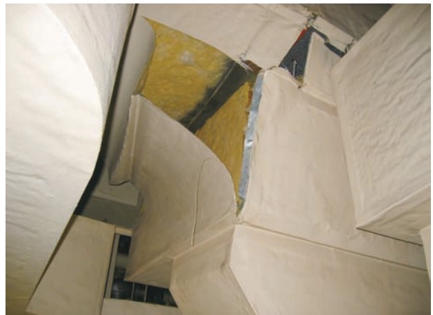
(中央棟) 空調機械室飼育系統送風機ダクト落下、破損
